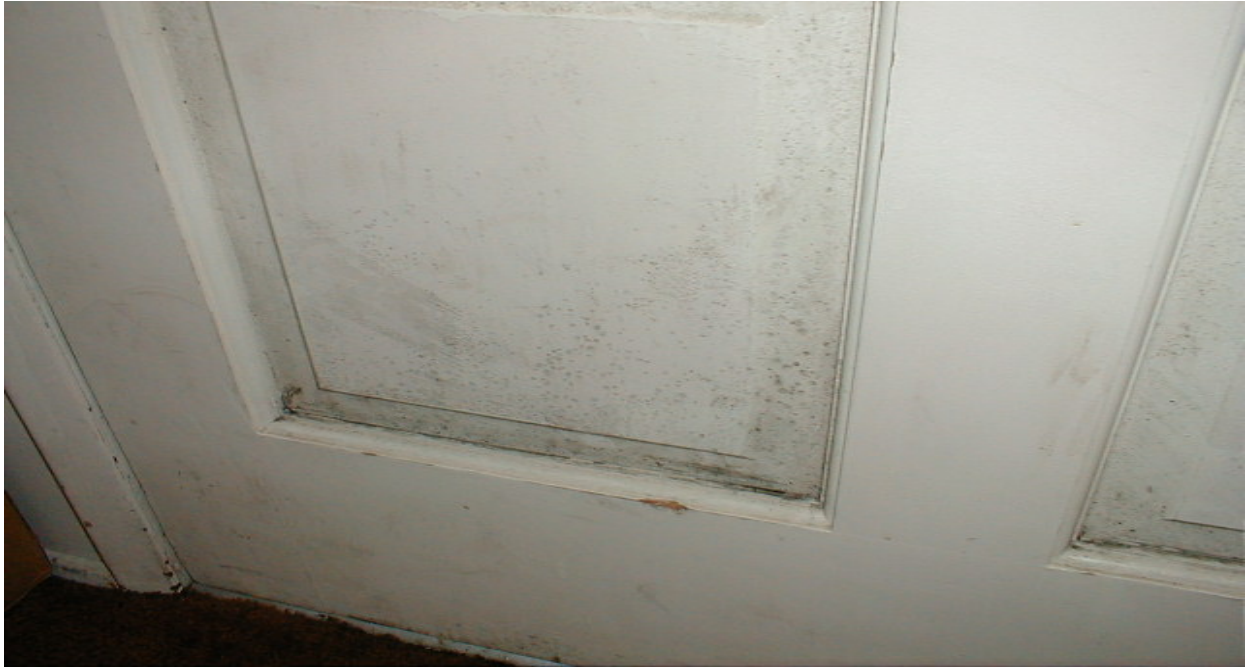
Figura 6. Condensación: crecimiento de moho en la superficie interior de una puerta hacia el exterior. Para reiterar, cuando una superficie fría entra en contacto con aire húmedo, se moja y se producen las condiciones necesarias para que crezca el moho. Esto puede lavarse y volver a pintarse.
