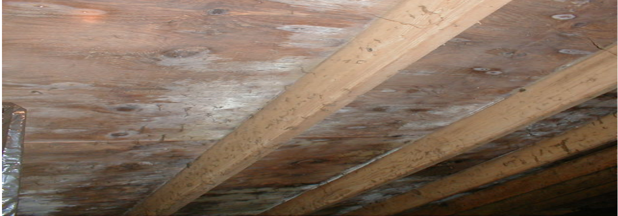
Figura 8. Condensación: moho en el revestimiento del techo en un ático. Durante los meses de invierno, la humedad (vapor del agua) que sale por el techo de las zonas habitadas, con la fuerza del aire tibio ascendente, se condensa en el revestimiento del ático frío. Esto causa daños a la propiedad y exposición al moho para los inquilinos. Si este problema se deja sin corregir, el techo se dañará y deberá ser reemplazado.
