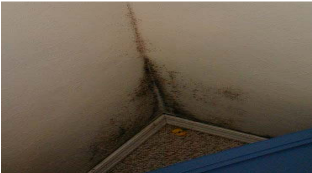
Figura 5. Condensación: crecimiento de moho en la esquina de un dormitorio correspondiente a una pared exterior. La combinación de un nivel alto de humedad relativa debido a la respiración de los inquilinos durante
