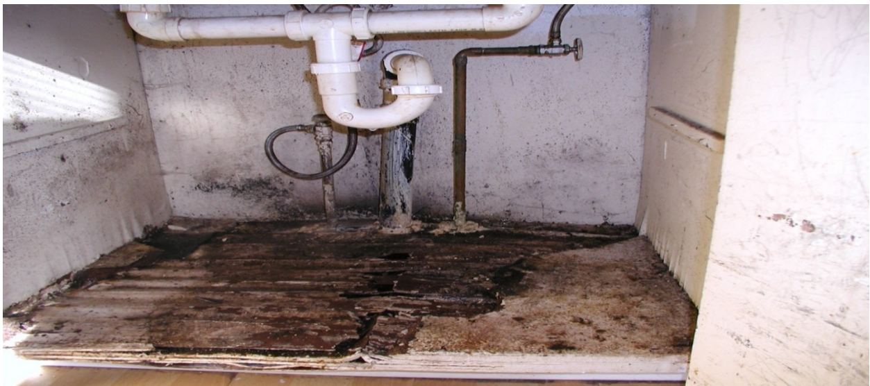
Figura 9. Fuga en una tubería: La comunicación oportuna con el propietario podría haber prevenido este daño.
