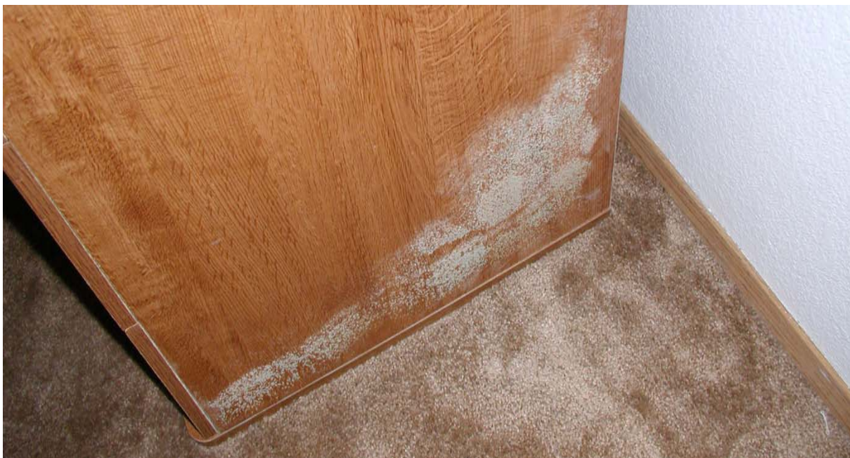
Figura 3. Moho causado por la condensación sobre el gabinete fresco situado contra una pared exterior de una unidad de alquiler. El origen del problema fue el exceso de humedad relativa interior (que superaba regularmente el 60%). Esta superficie puede limpiarse con agua jabonosa.
