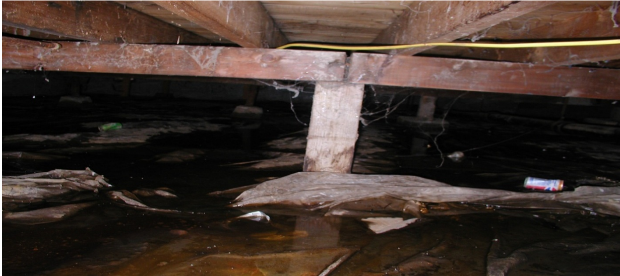
Figura 7. Agua empozada en un espacio debajo de la casa: el 40 % del aire que usted respira puede provenir del espacio debajo de la casa, que sube gracias a la fuerza del aire caliente en ascenso. El exceso de humedad en el espacio debajo de la casa es perjudicial para su salud y es dañino para la estructura. Además, es un factor importante en el desplazamiento de la humedad relativa hacia ARRIBA.
