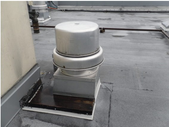
Photo #39: Exhaust fan
