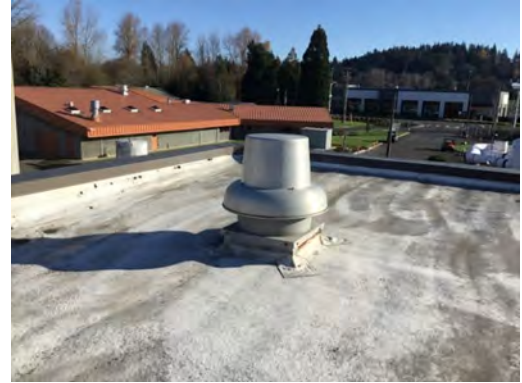
Picture 42. CAS CCB De-chlorination Room Exhaust Fan
